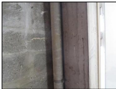
Photo N° 1283 AMIANTE CIMENT Fourreau
